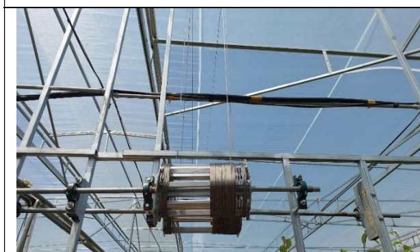
Motor điều khiển hệ thống rải lưới
